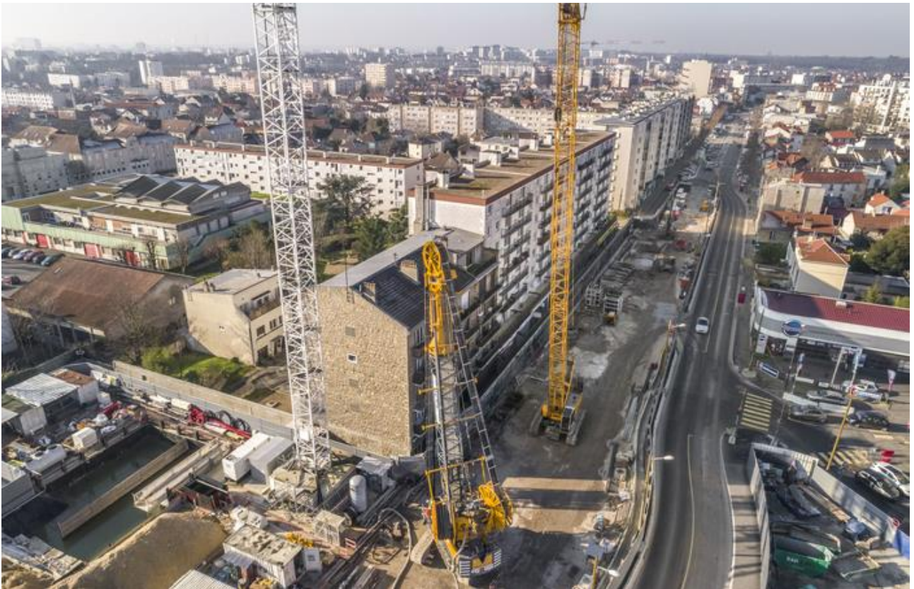
Figure 10 : Photo aérienne des travaux de l'ouvrage d'entonnement de Chamoigny-sur-Marne situé av. Roger Salengro. Source : Eiffage Génie Civil – Razel-Bec / Dronit & Hervé Piraud, URL : https://www.societedugrandparis.fr/salengro
